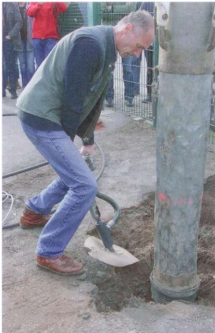
Bei sehr bindigen Böden sprengt der Gärtner mittels einer Druckluftlanze die oberen Bodenschichten auf.
