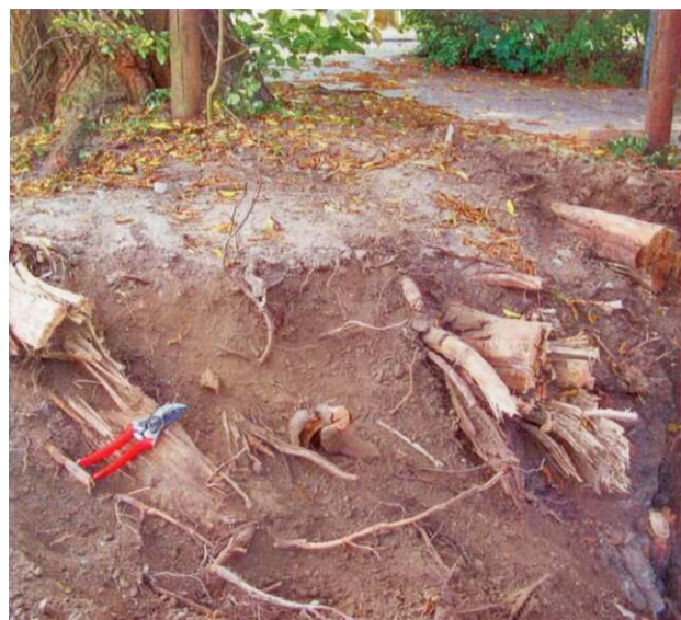
Erhebliche Wurzelabrisse durch Baggerarbeiten. Um solche Schäden zu vermeiden, sollten vor Baubeginn Wurzelsondierungen erfolgen, um die Eingriffserheblichkeit zu beurteilen.
