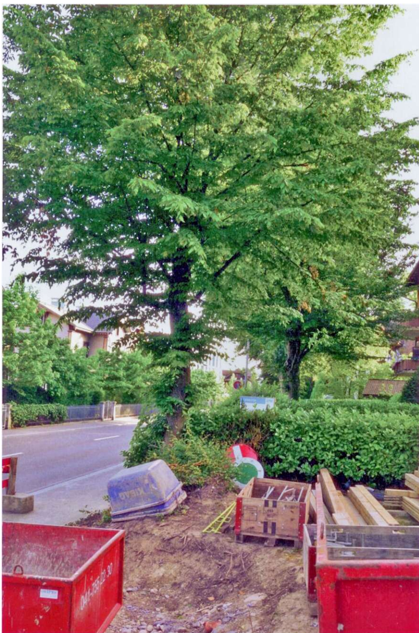
Fehlender Baumschutz im Baustellenbereich wie es leider häufig vorkommt.
